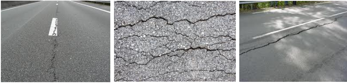
Figure 1. Divers exemples de fissuration de la chaussée
