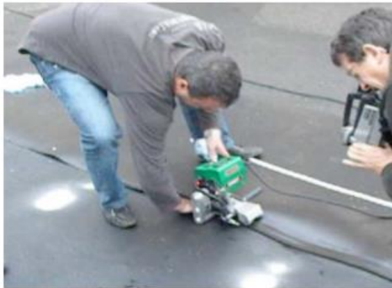
Vue de la machine en cours de soudage et de l'acquisition des images thermographiques
